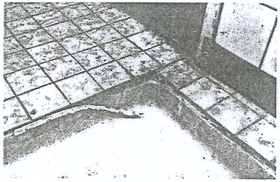
KWALITEIT Renovatieproject Tilburg (loslatende kitvoeg douchevloer). → lekkage!
