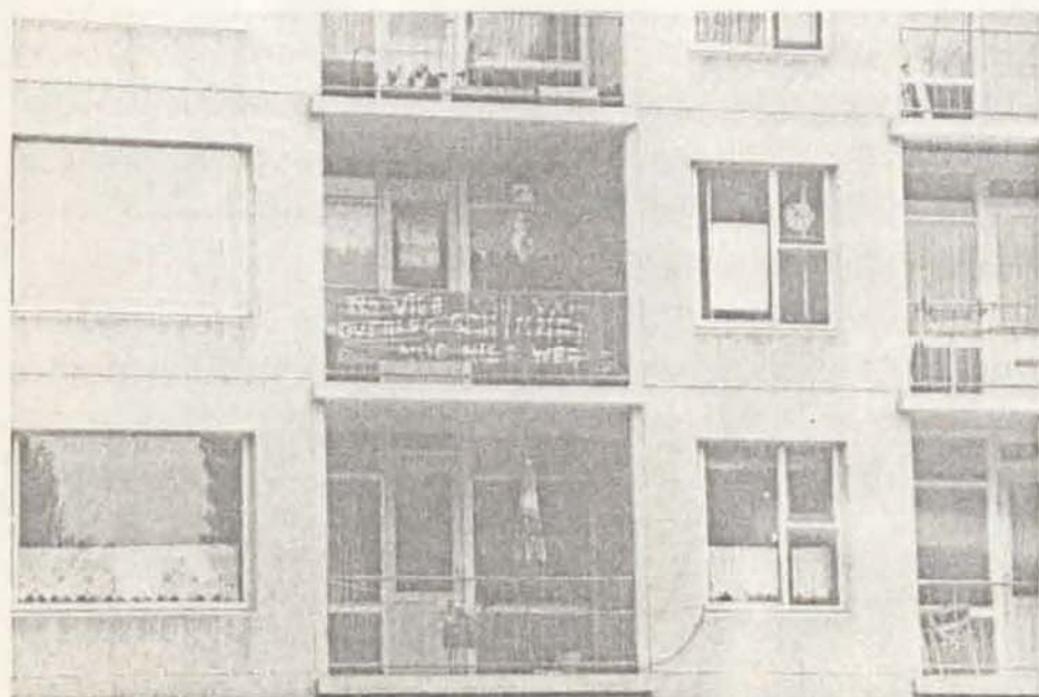
"Na vier jaar van overleg SCHIMMEL nog niet weg"
