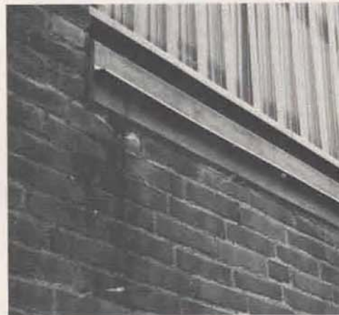
Gevelvervulling en aantasting voegwerk
