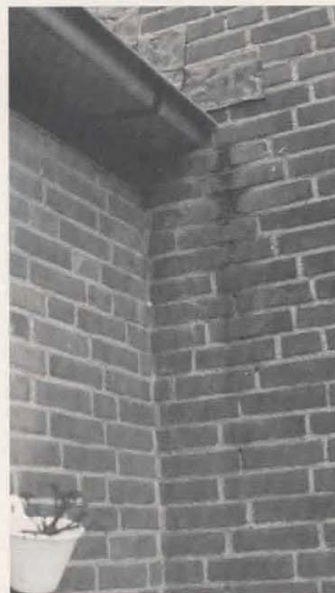
Aantasting voegwerk door onjuist gootdetail
