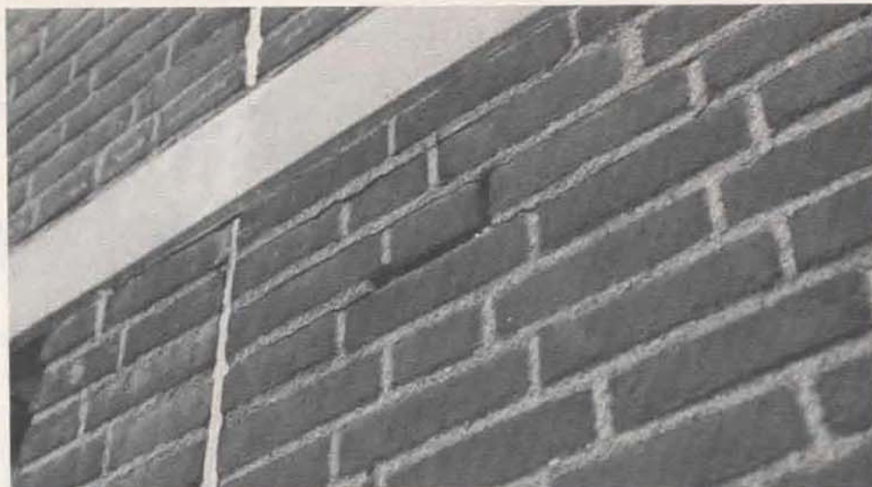
Voegwerk boven betonband en kitvoeg vragen extra onderhoud
