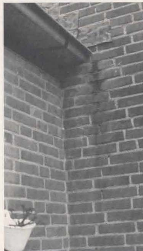
Aantasting voegwerk door onjuist gootdetail
