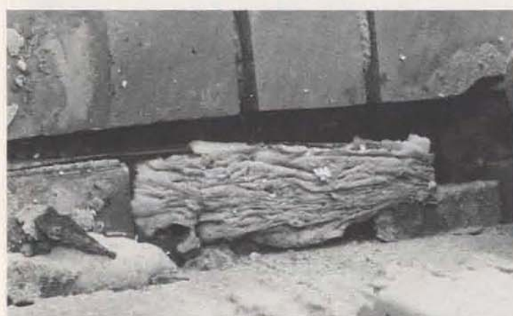
Kans op vochttafvoer via binnenspouwblad
