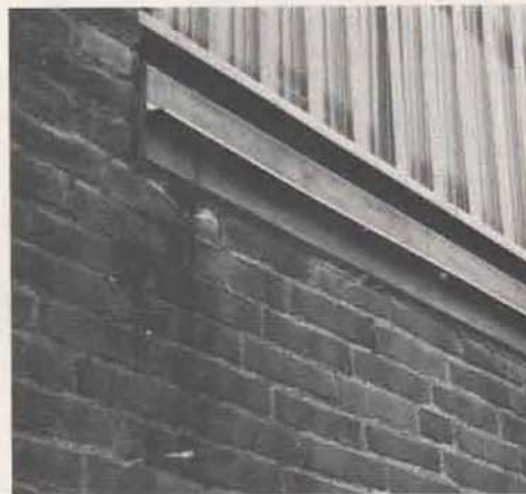
Gevelvervulling en aantasting voegwerk
