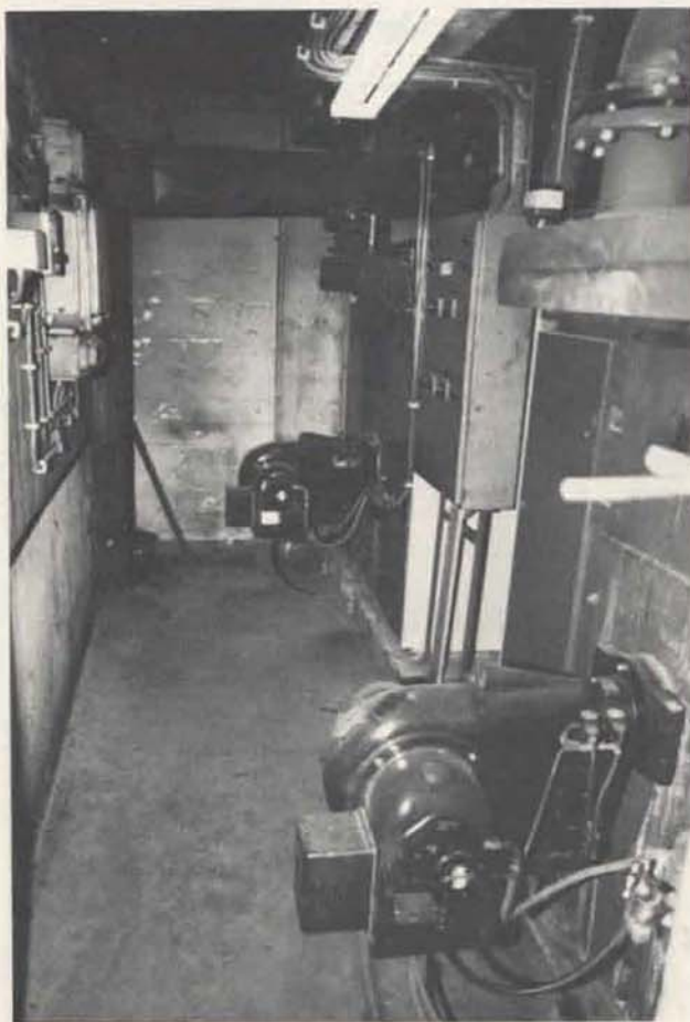
de oliegestookte installatie van het complex aan de Slotermeerlaan
