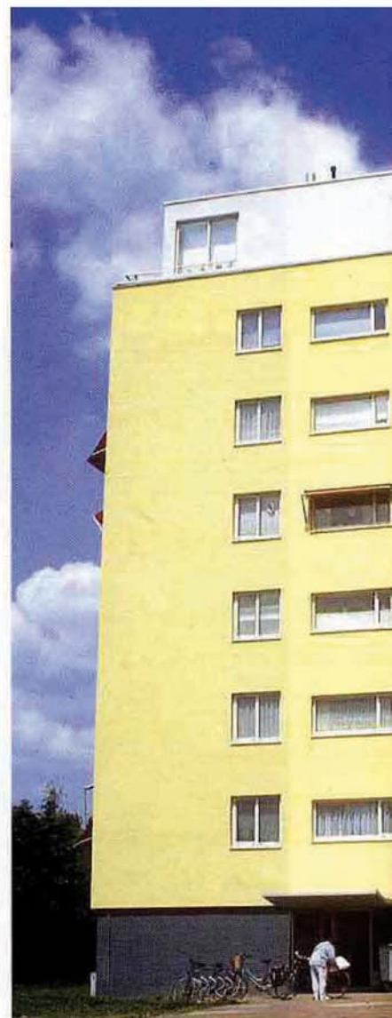
De nieuw aangebrachte buitengevelisolatie verbetert niet alleen de slechte isolatie maar geeft het gebouw ook een eigentijdse uitstraling.
