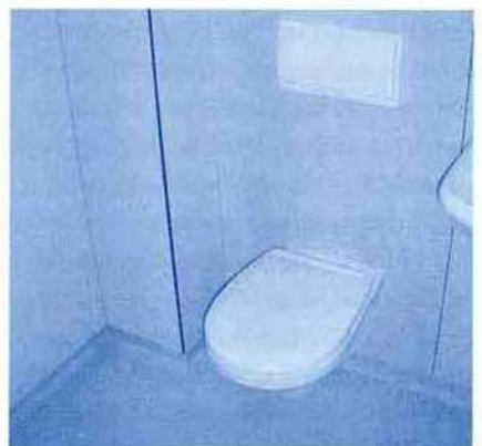
Foto 2: Een flexibele douche en toilet oplossing, waarbij optimaal aan de bewonerswensen, nu en in de toekomst, tegemoet kan worden gekomen.
