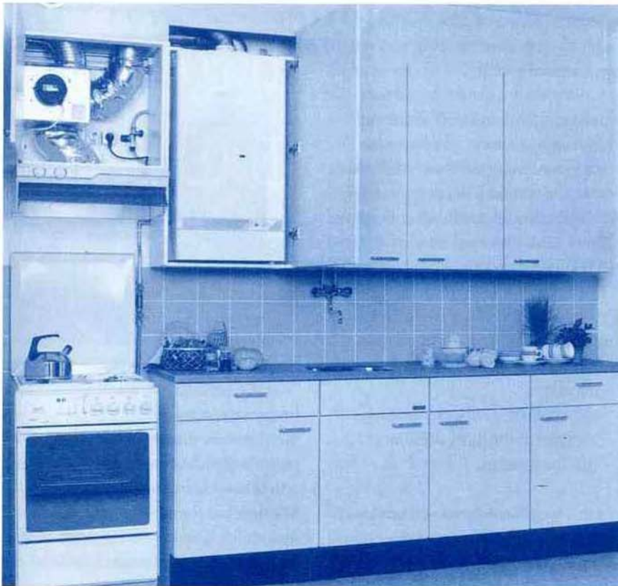
Foto 1: Keuken, de cv-installatie is optimaal in de keukenkastjes weggewerkt.
