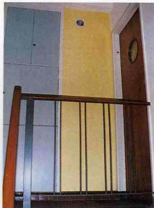
Van de vier nieuw aangebrachte ventilatiekanalen is er één bestemd voor het ventileren van het trappenhuis. De overige drie zijn bestemd voor de mechanische ventilatie van de woningen tot en met verdieping drie. De woningen op de vierde verdieping ventileren rechtstreeks naar buiten.
