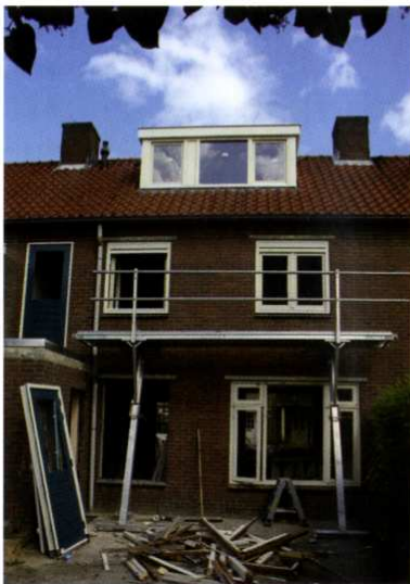
De woningen krijgen onder andere dubbelglas in nieuwe kozijnen, ramen en deuren, isolatie en een dakkapel.
